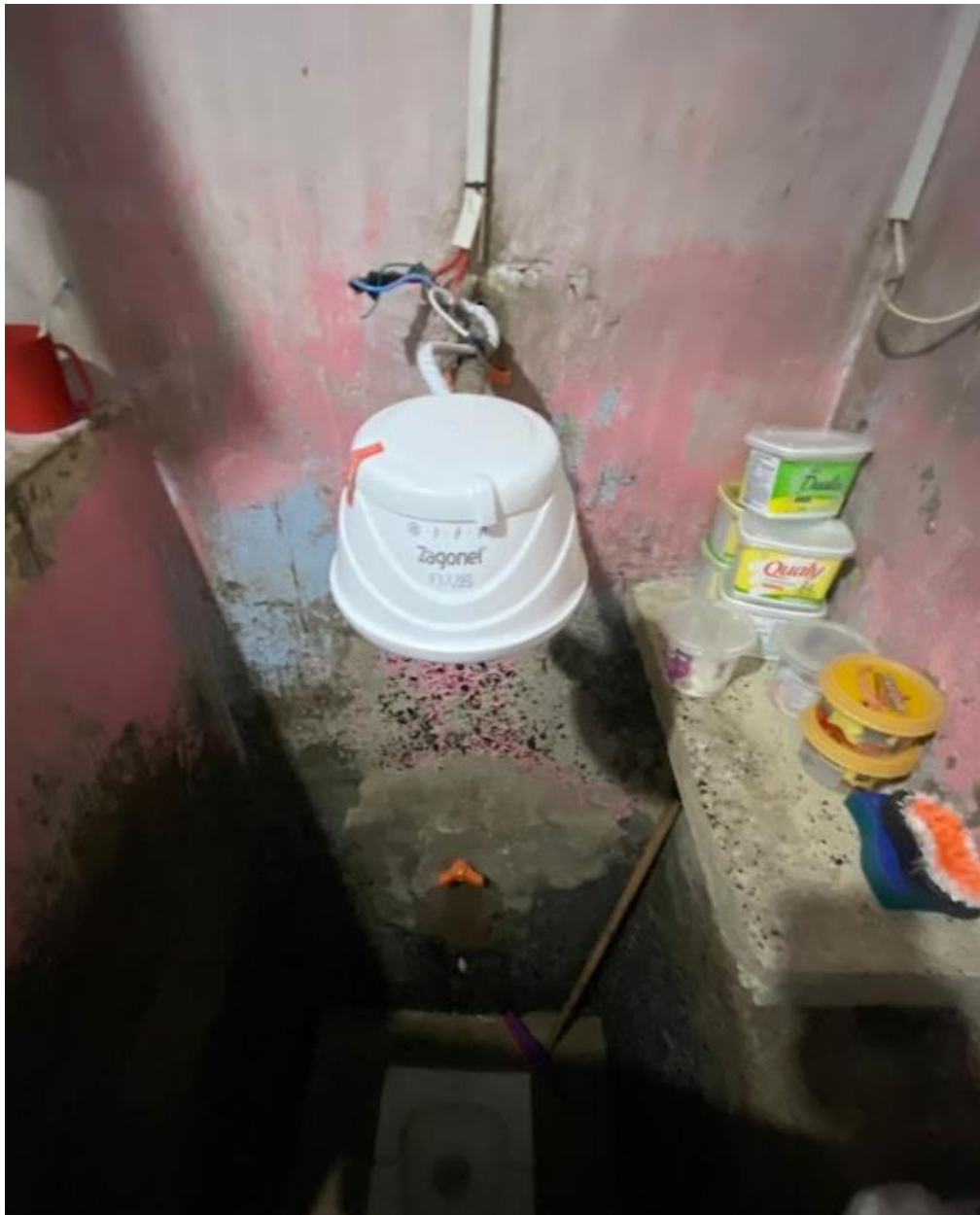
Chuveiro com vazamento no registro
