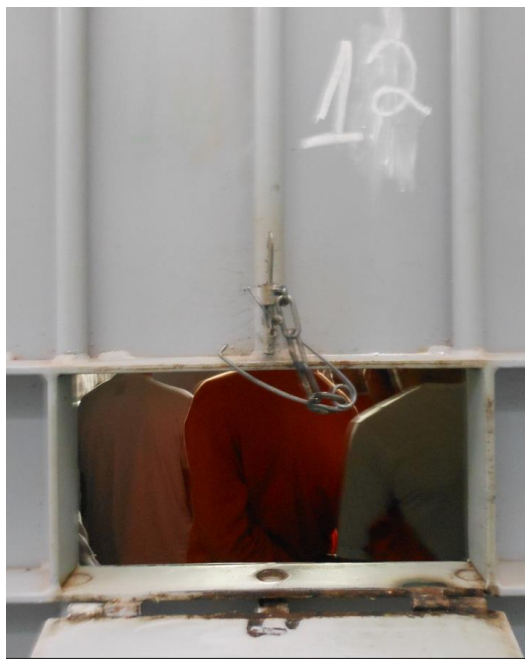
Galeria 04 - Indicação feita pela própria unidade de que a cela possui 12 pessoas.
