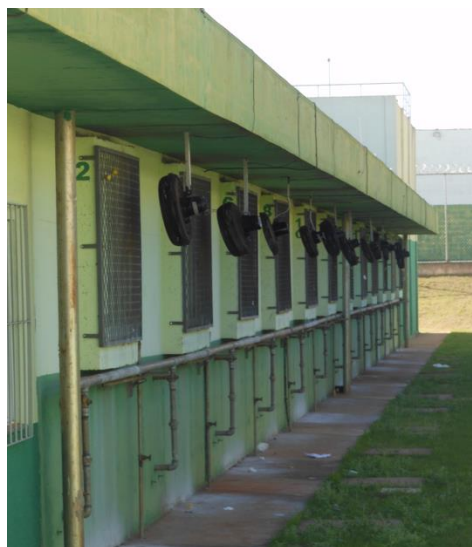
Ventiladores externos da Galeria 02.
