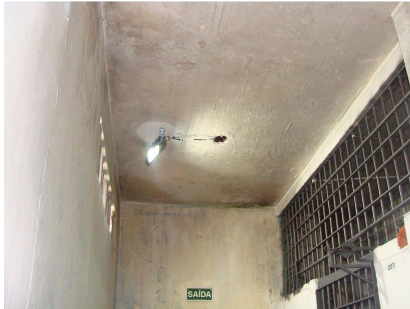
Abertura dos cubículos e as paredes úmidas
