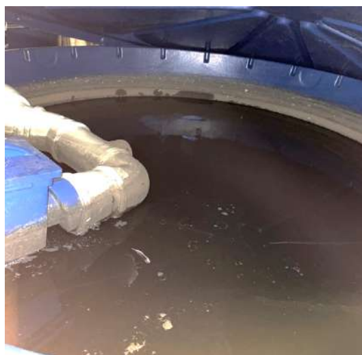
Figura SEQ Figura \* ARABIC 10: Cisterna da Sede Central de Atendimento da DPE.
