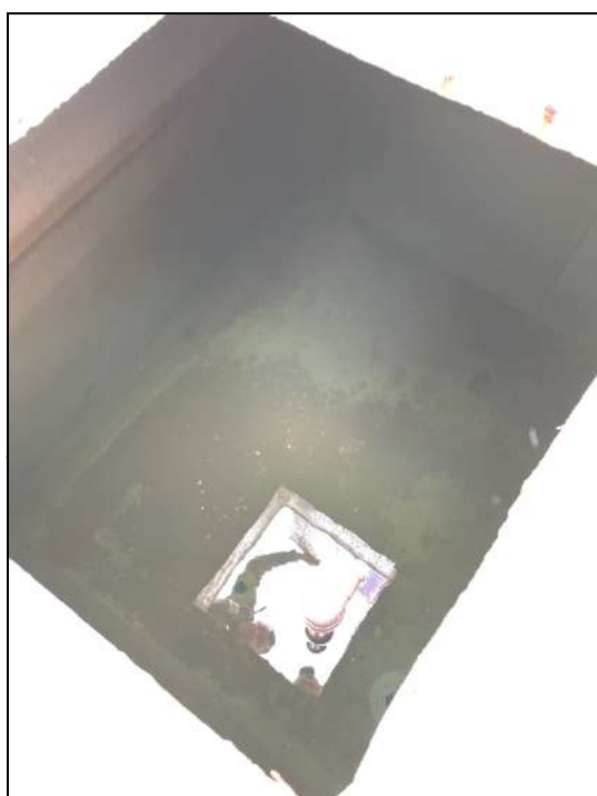
Figura SEQ Figura \* ARABIC 7: Caixa D'Água P/Consumo da Sede dos Núcleos, EDEPAR e Corregedoria-Geral da DPE.
