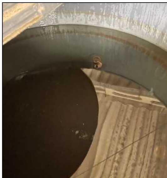
Figura SEQ Figura \* ARABIC 6: Caixa D'Água P/Consumo do Centro de Distribuição e Logística e Almojarifado Central da DPE.
