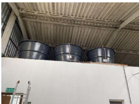
Figura SEQ Figura \* ARABIC 5: Caixa D'Água P/Consumo do Centro de Distribuição e Logística e Almojarifado Central da DPE.
