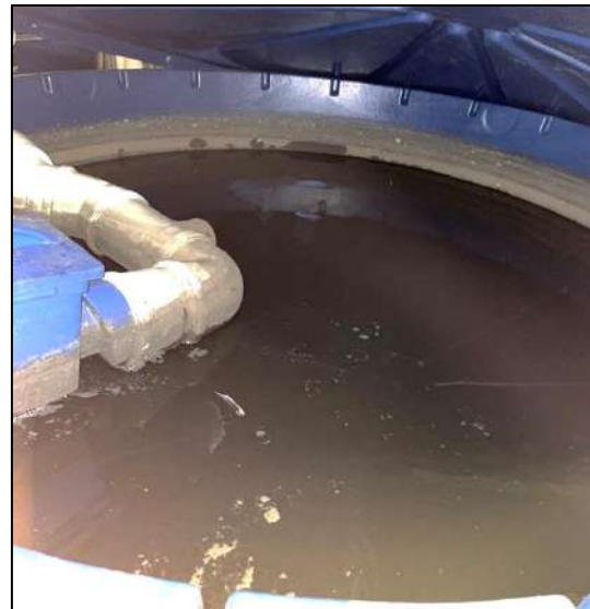
Figura 10: Cisterna da Sede Central de Atendimento da DPE.
