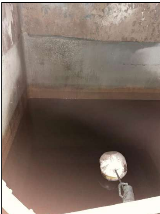
Figura 12: Cisterna da Sede Núcleos, EDEPAR e Corregedoria-Geral da DPE.
