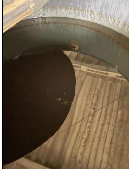
Figura 5: Caixa D'Água P/Consumo do Centro de Distribuição e Logística e Almoxarifado Central da DPE.
