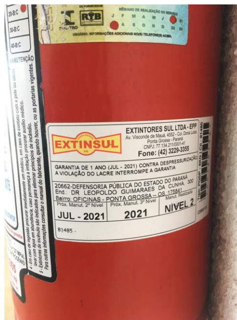
04 – Extintor PQS 4Kg
