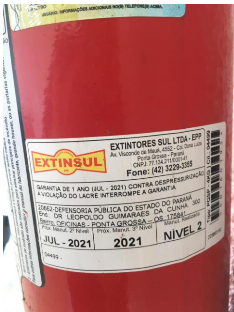
03 – Extintor PQS 4Kg
