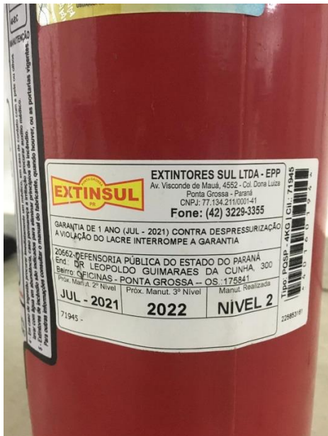
01 – Extintor PQS 4Kg
